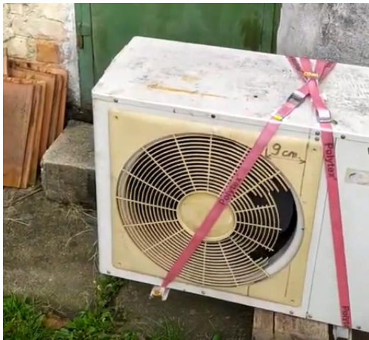
ábra 3: heveder rögzítése a kompresszor oldalán
